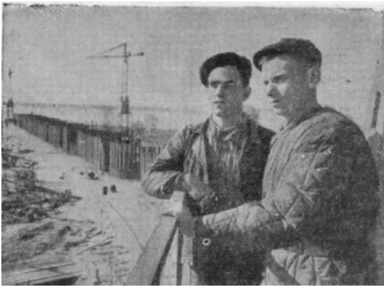
Продольная шпунтовая перемычка оградит котлован от днепровских вод. Свыше тысячи тонн шпунта уже забито в тело перемычки. До двух норм в смену выполняет бригада комсомольца А. Добродия. На снимке: бригадир Алексей Добродил и стахановец машинист башенного крана Николай Сорокин.
