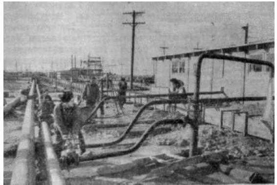
На Каховском гидроузле началась откачка воды из котлована иллуза. На снимке: одна из насосных установок, откачивающих воду.
